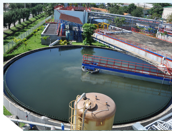
Trạm xử lý nước thải
